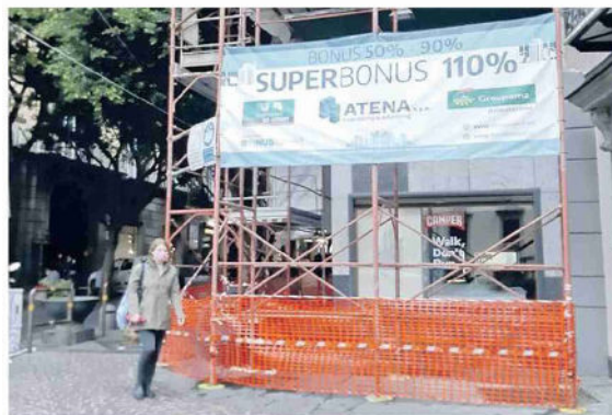
Imprese in allarme dopo la decisione delle Poste di sospendere l'acquisto dei crediti da bonus edilizi
