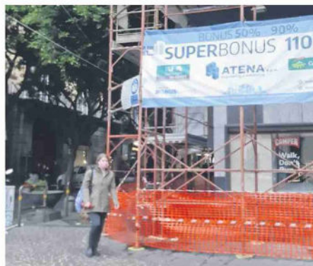
Imprese in allarme dopo la decisione delle Poste di sospendere l'acquisto dei crediti da bonus edilizi
