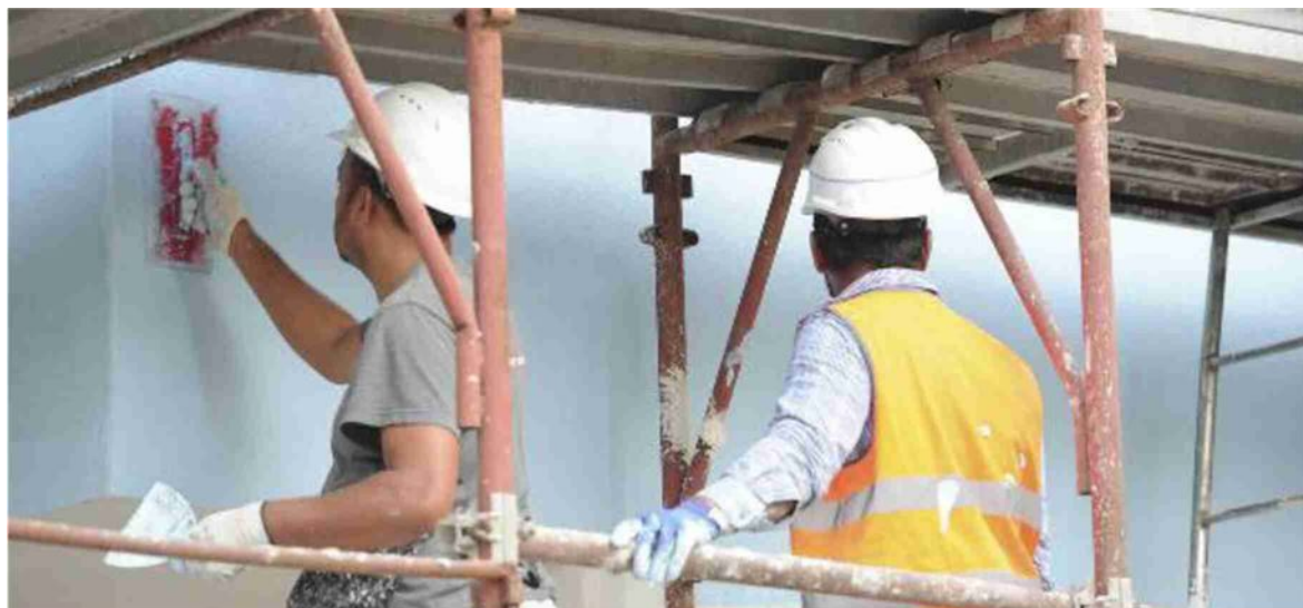
Un cantiere a Modena dove gli operai stanno ristrutturando la facciata di un palazzo
